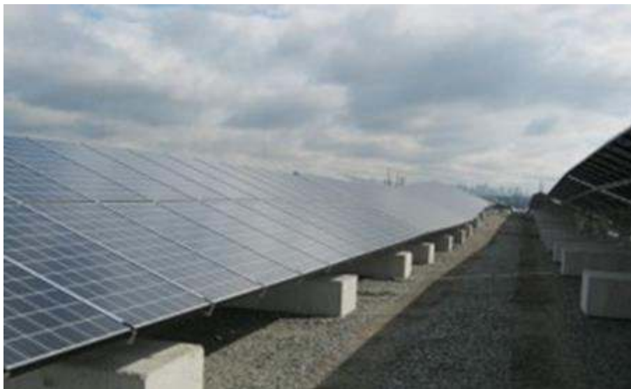
Slika 22. Sunčana elektrana na betonskim blokovima
