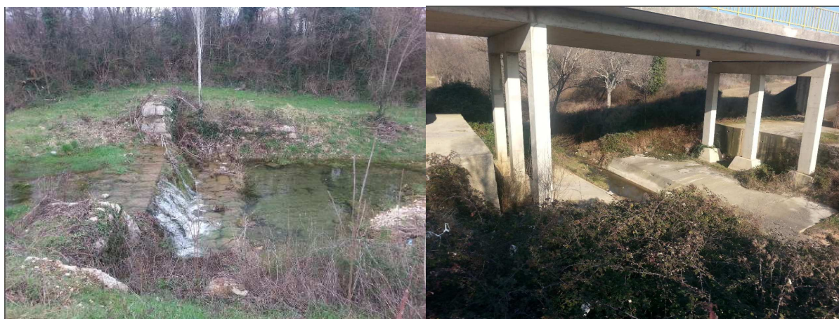
Slika 2.3-4 Kamena pregrada trapeznog poprečnog presjeka sa kaskadom (lijevo) i betonirani dio korita ispod mosta (desno).
