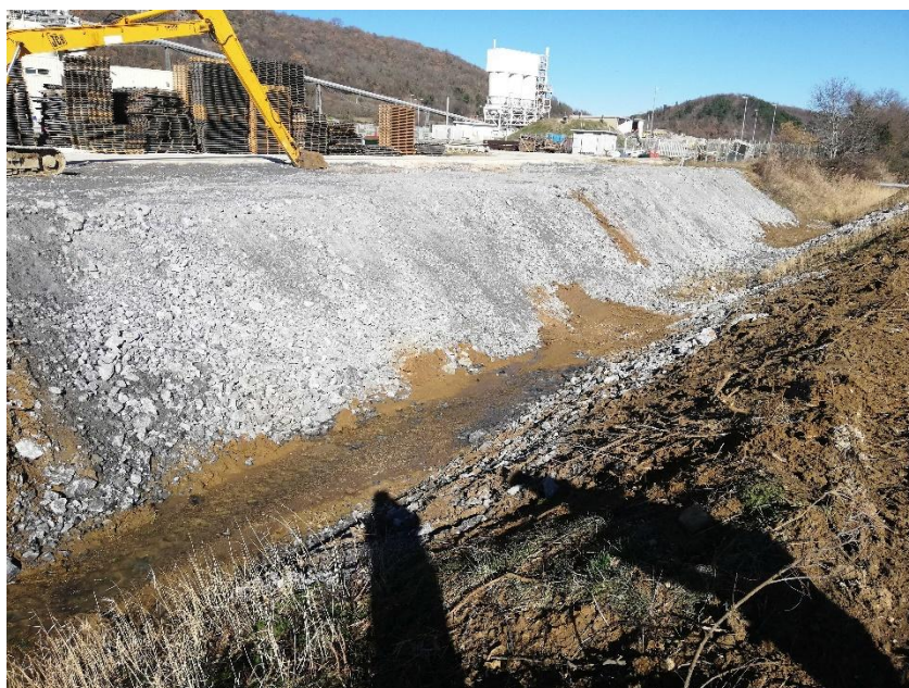
Slika 2.2.2 Radovi hitne sanacija lijeve obale (s kojima nije zaustavljeno urušavanje, P-13 nizvodno)
